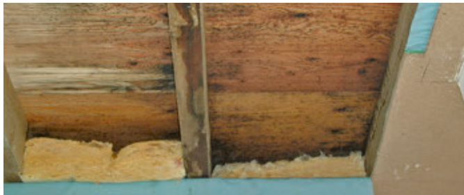
Plíseň vzniklá v místě, kde zůstala uvězněná vlhkost
