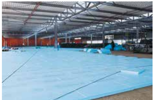
Abb. 39: XPS Bodendämmung in einer Werkshalle
