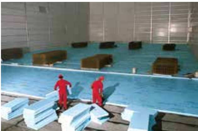
Abb. 38: XPS Bodendämmung in einem Tiefkühlhaus
