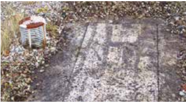
Abb. 46+47: Entnahme einer 32 Jahre alten XPS-Dämmplatte aus dem bekiesten Umkehrdach des Verwaltungsgebäudes der Hamburg-Mannheimer Versicherungs AG.
