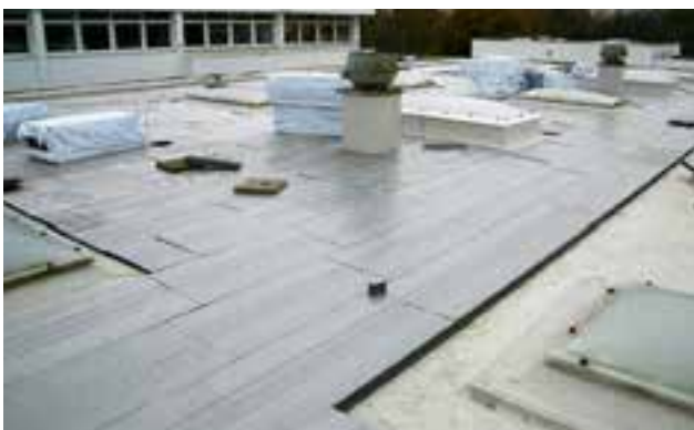
Abb. 43: XPS Platten werden im Verband verlegt, die Anschlüsse an Lichtkuppeln sind exakt anzuarbeiten
