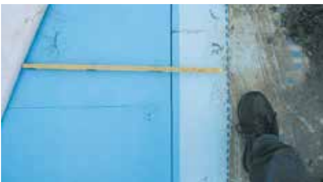
Abb.52: Die freigelegte XPS Platte zeigt so gut wie keine Ablagerungen auf der Oberfläche
