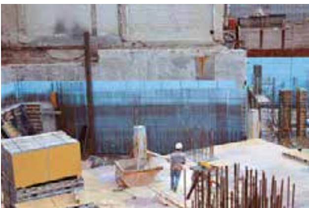
Abb. 30: Die Perimeterdämmplatten sind am Verbau befestigt, der als verlorene Schalung genutzt wird
